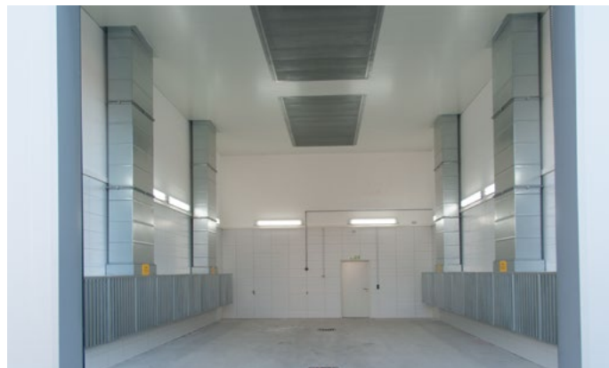
Cabine de lavage avec préparation à la peinture, 12 x 7 x 6.8 m et ventilation.
