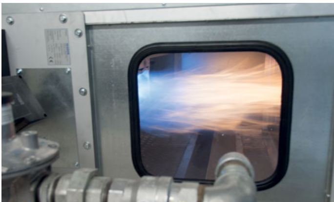
Brûleur à gaz.
