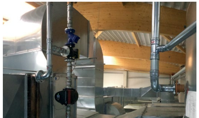
Echangeur d'eau chaude.
