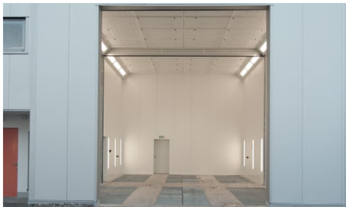
Cabine de peinture avec cloison de séparation, 12 x 7 x 6.8 m. Aussi chaque zone peut être utilisée comme local de séchage.
