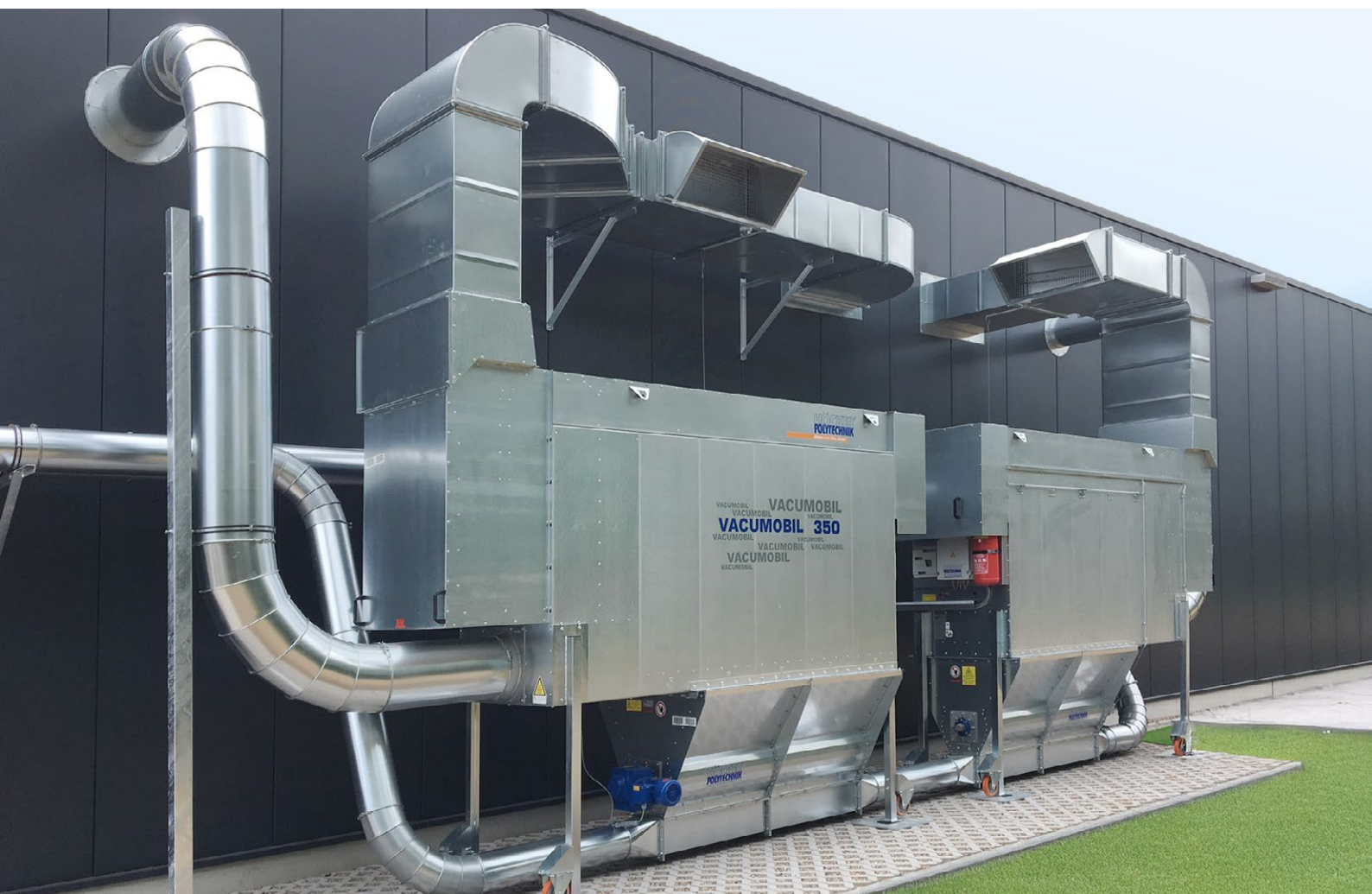
Deux Vacumobil JZ 350 en installation extérieure. L'air filtré est réinjecté dans la production et l'énergie thermique est conservée.
