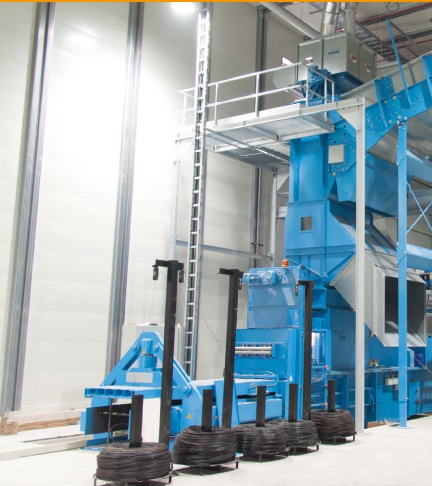
Séparateur de matière PMA-U comme solution interne dans la fabrication de cartons ondulés.
